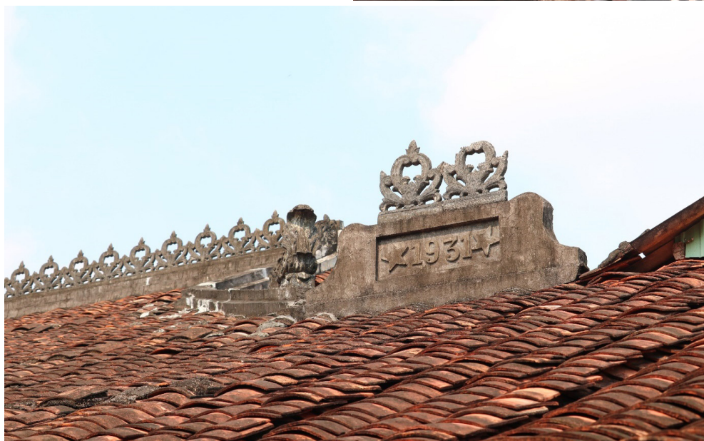
Chưa đầy 100 năm tuổi nhưng nhà ông Võ cũng đã hư hại nhiều chỗ
